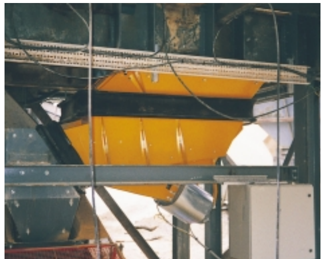
Förderrinne zu einem Förderband
